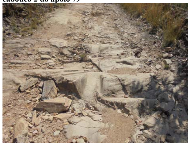
Figura 16 Marcas de passagem de veículos no acesso ao apoio 72.
